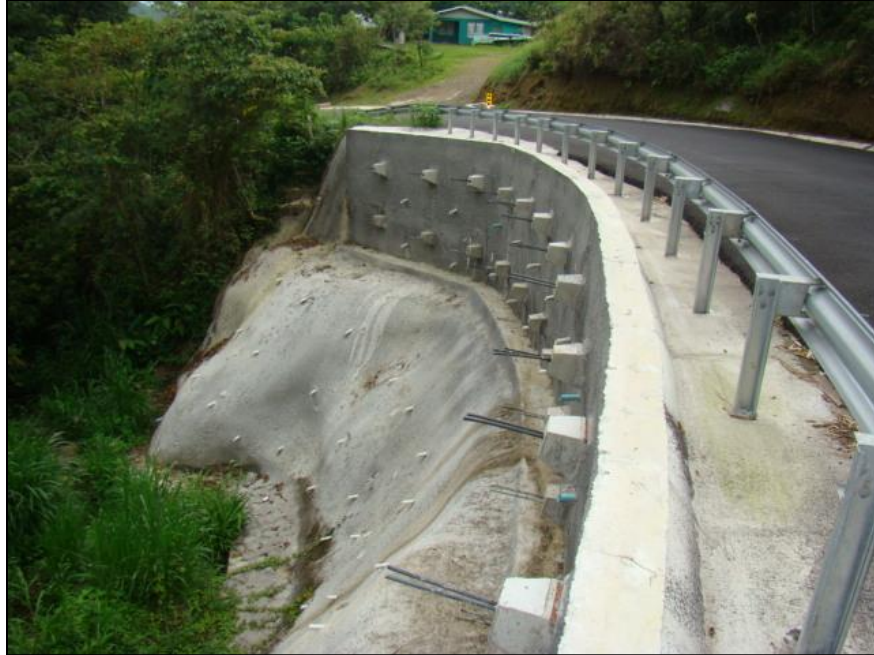
Figura 41. Fotografía de los drenajes en Rincón de Mora realizados en la carretera que conecta San Ramón Centro con Llano Brenes.
