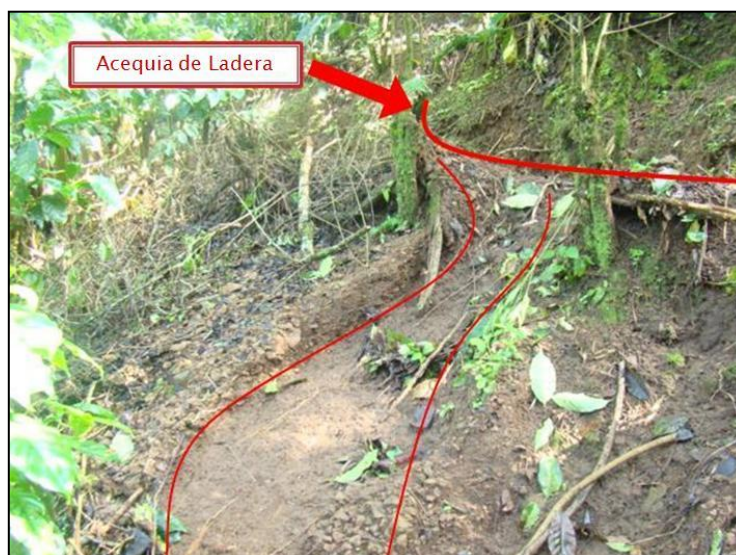
Figura 32. Fotografía de la acequia de ladera colapsada en el área de muestreo CMS-60+A, tomada en setiembre del 2013.
